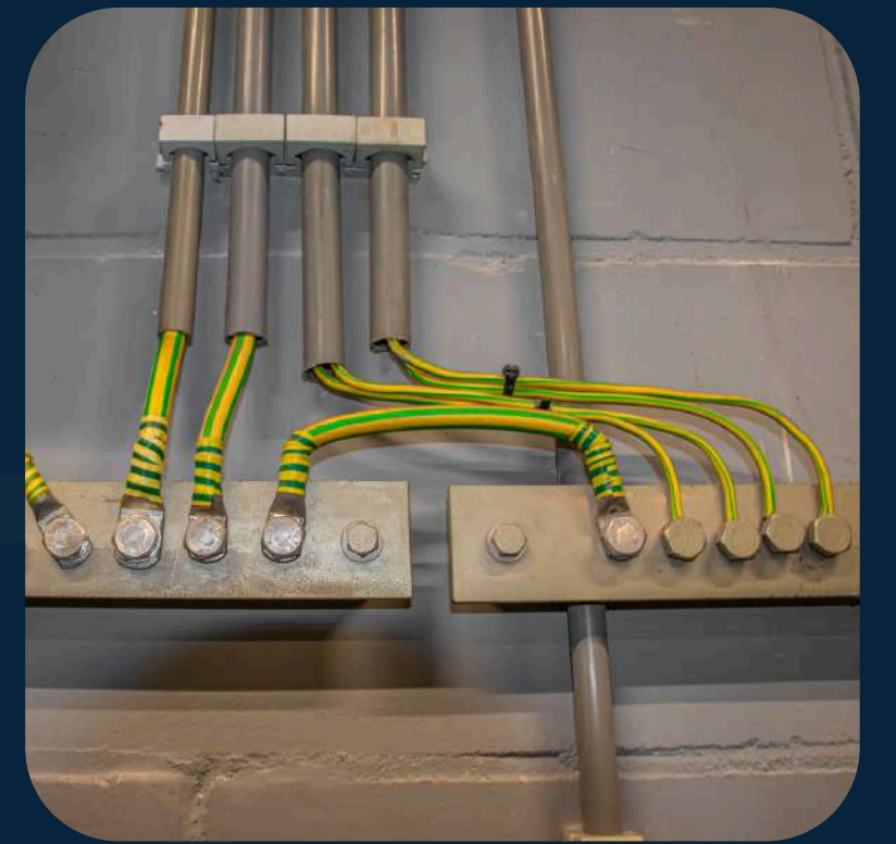
تأريض كهربائي لكامل المبنى
